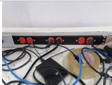
Conectores de la mesa 1 de mantenimientos
