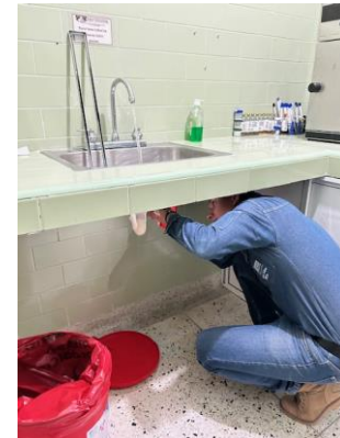
Revisión de fuga de agua en el área de Microbiología
