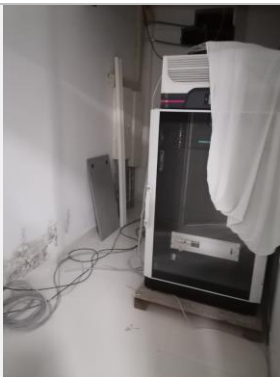
Bodega de servidores (no está funcionando)
