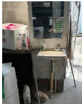
Zona de lavado
