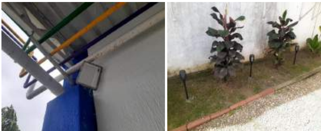
Lámparas solares instaladas para alumbrado de jardines internos
