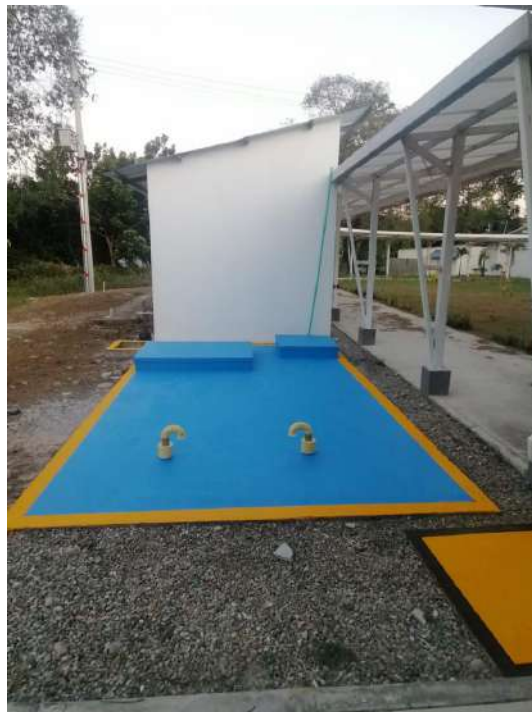
Fotografía 3 Señalización tanque subterráneo de agua potable nueva área de UCI
